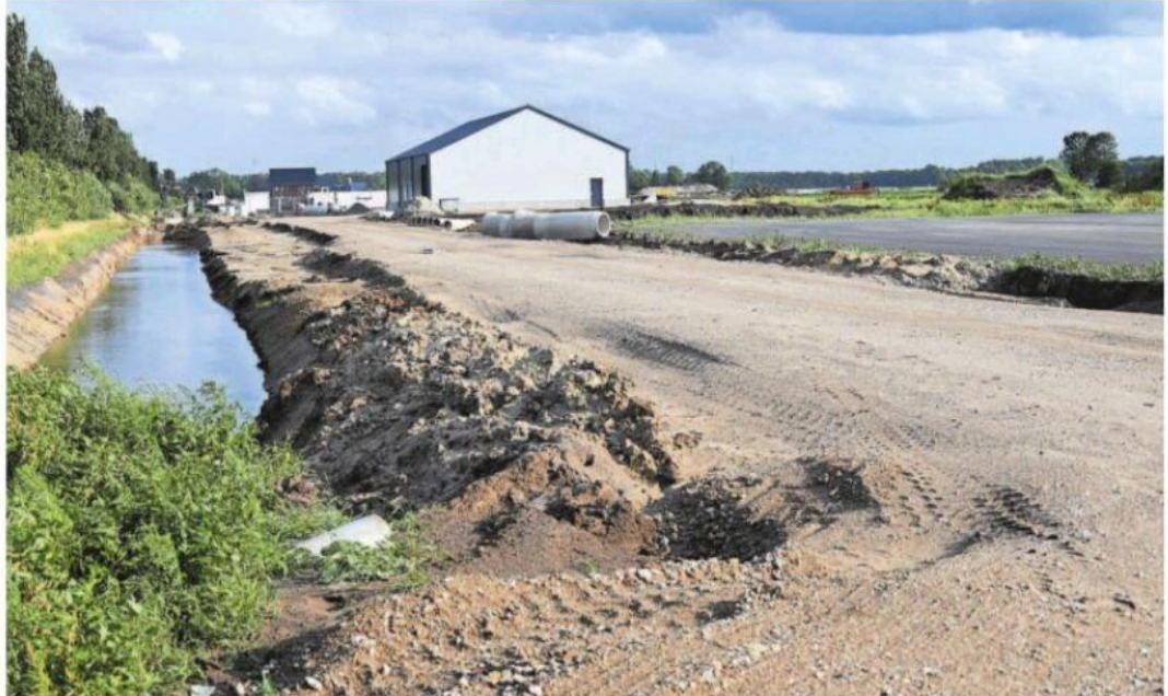
Er wordt momenteel hard gewerkt aan de infrastructuur van de uitbreiding van Hoge Akkers in Ruinerwold. ARTIZEL MEDIA / PETER NEFKENS
